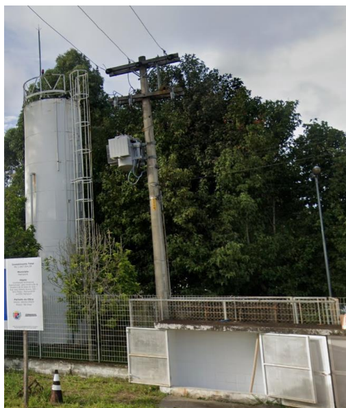
Posto de Transformação Simplificado Existente
