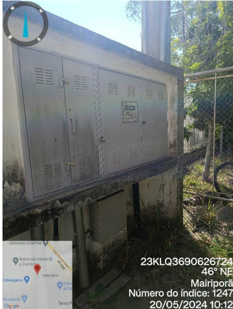
Abrigo de Proteção e Medição
