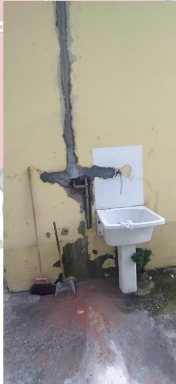
Foto 9 – Área de Serviço, lado esquerdo
