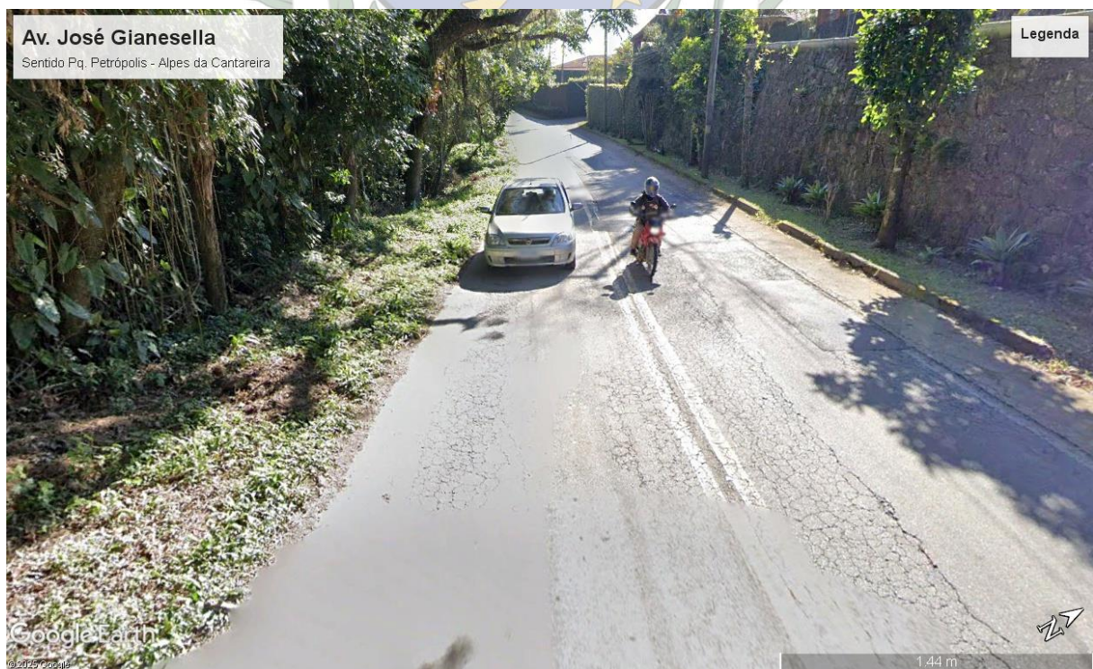
Imagens Google Earth – Danificações do asfalto
